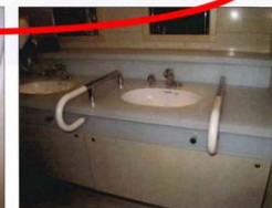
圖 3.5.7.6 一般廁間洗手台設置扶手
